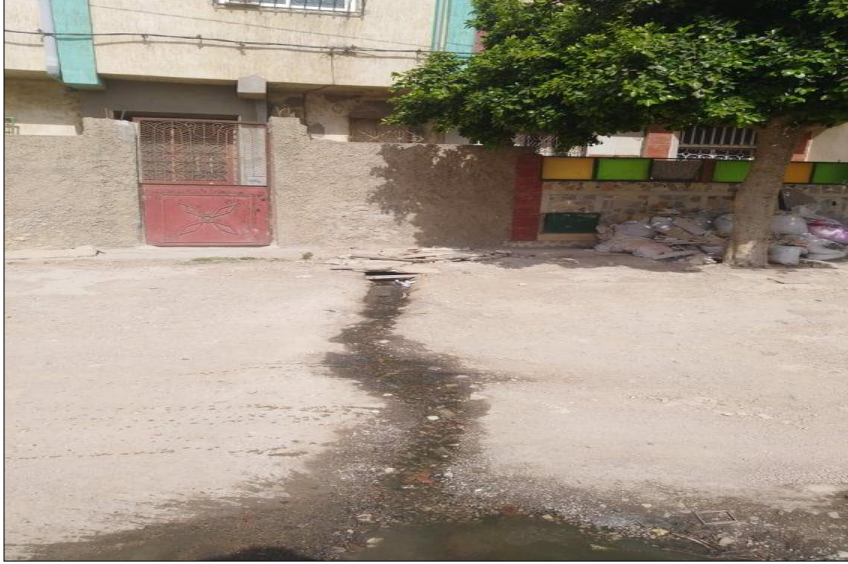
الصورة (7): تسرب مياه حفرة صحية بأحد المنازل بجماعة أزلا.
